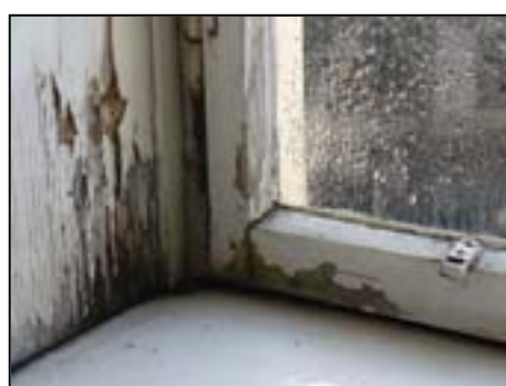
BESTAND innen morsche Holzstöcke und Fensterflügel. Durch den Wassereintritt der undichten Fenster treten schon schwere Schäden am Mauerwerk auf.
